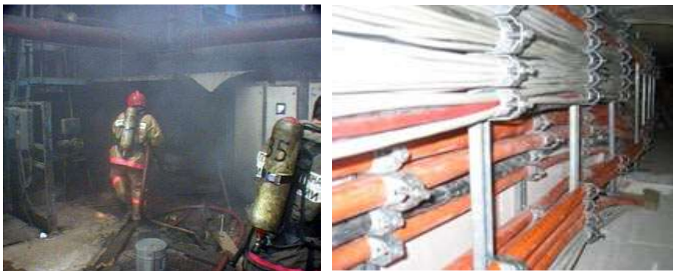
Рис. 11. Кабельное сооружение и ликвидация пожара
