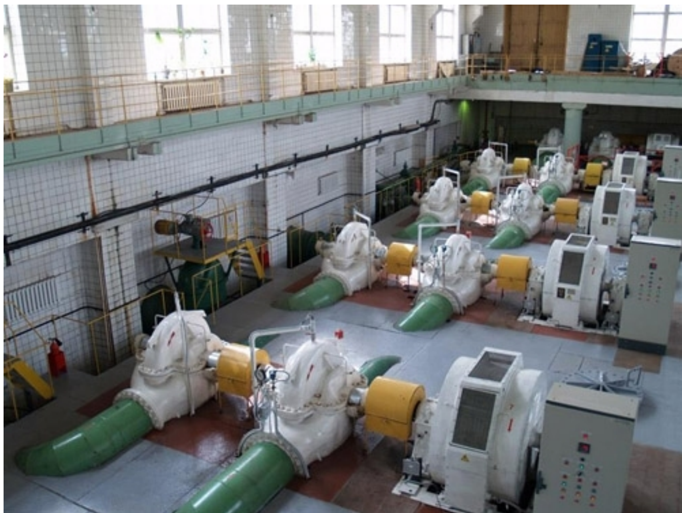
Рис. 4.4. Машинный зал насосной станции I-го подъема со спаренными насосами типа Д, с приводом от одного электродвигателя
