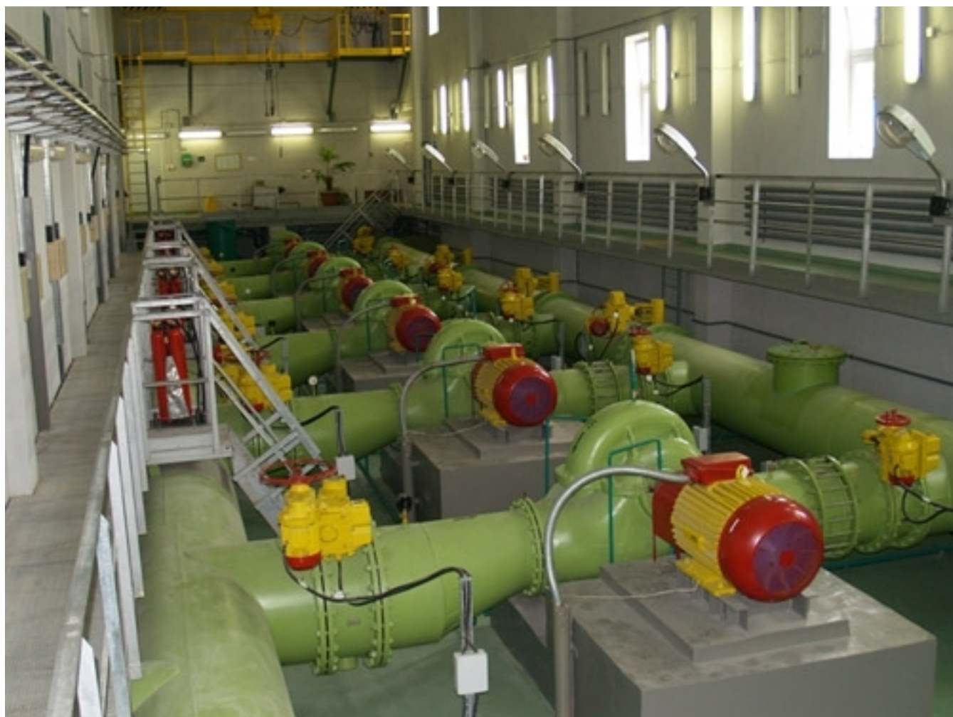
Рис. 4.5. Машинный зал насосной станции II-го подъема с насосами типа Д.
