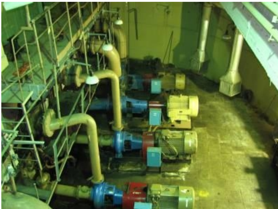
Рис. 4.12. Внешний вид канализационной насосной станции с насосами типа СД (СМ)
