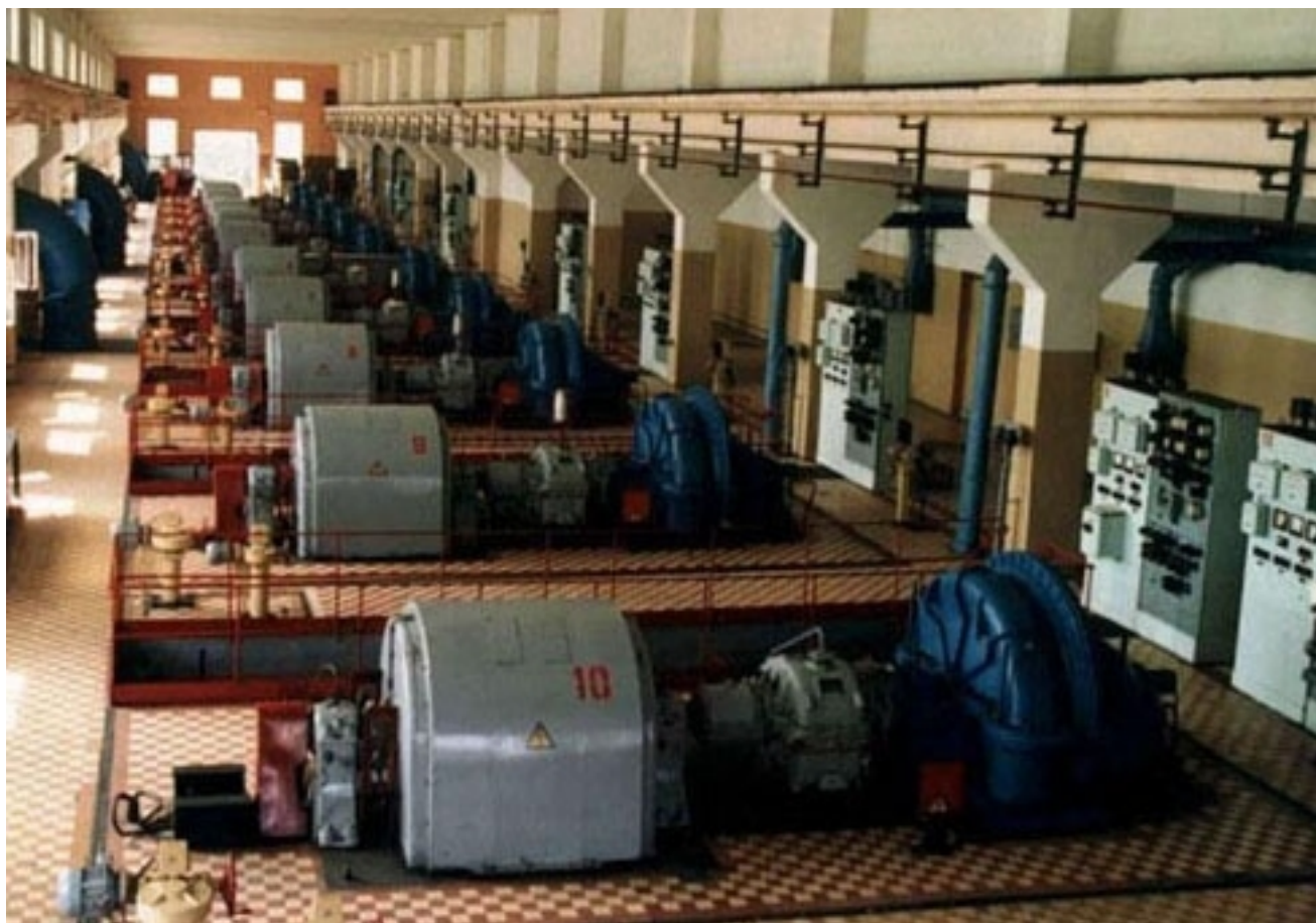
Рис. 3.4. Внешний вид машинного зала воздуходувной станции
