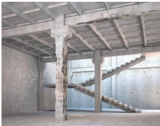
Рис. 5.5 Внешний вид поврежденной колонны
