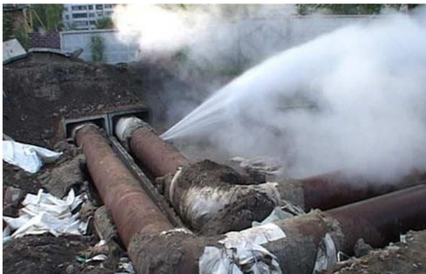
Рис. 4. Фактическое состояние тепловых сетей.
