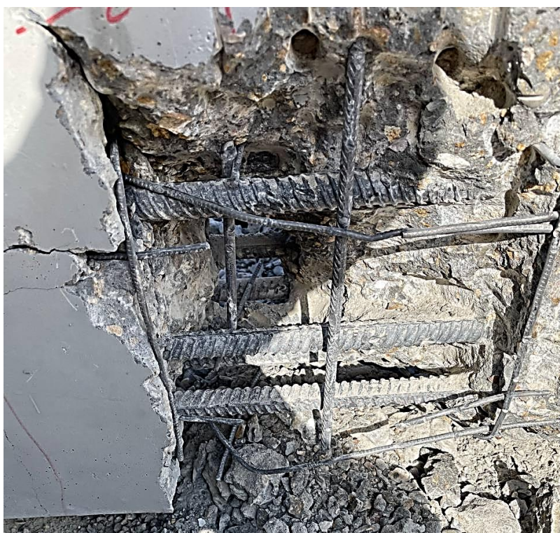
Рисунок 7.2. Вскрытие арматурных стержней нижнего пояса балки
