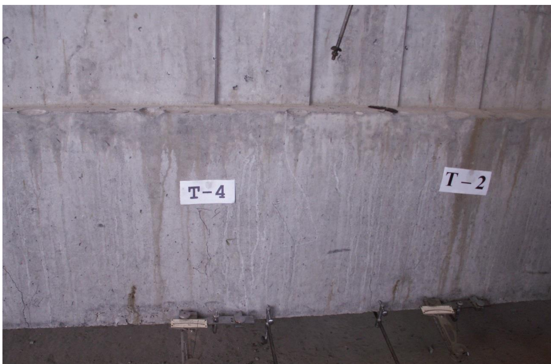
Рис. П.2.2. Образование первых нормальных трещин произошло на четвертом этапе нагружения при суммарной нагрузке P_4 = 251,4 кН (без учета собственного веса ригеля). Ширина раскрытия трещин после 10-минутной выдержки составила 0,05 мм.
