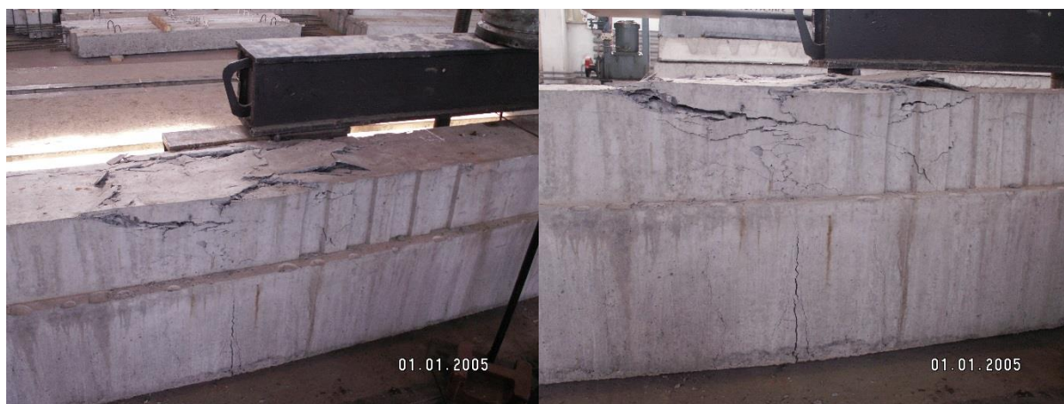
Рис. П.2.5. Характер разрушения ригеля РОП 6.86-60.
