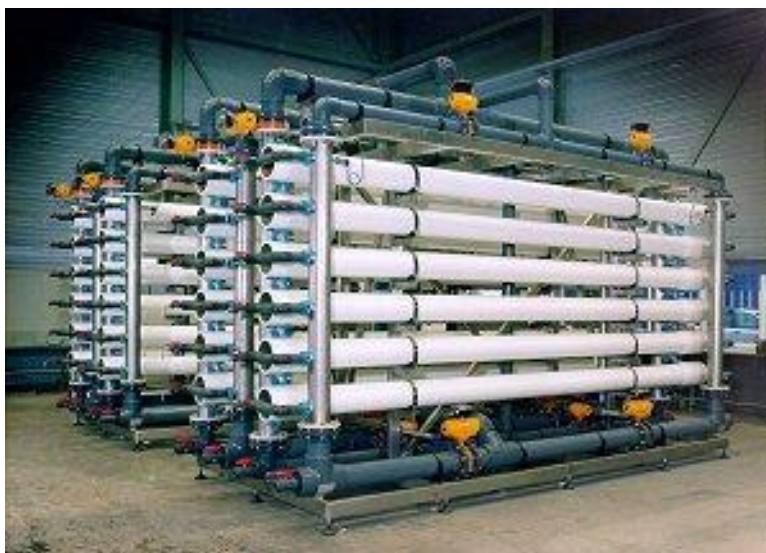
Рис. 3.23. Ультрафильтрационная установки очистки природных вод.
