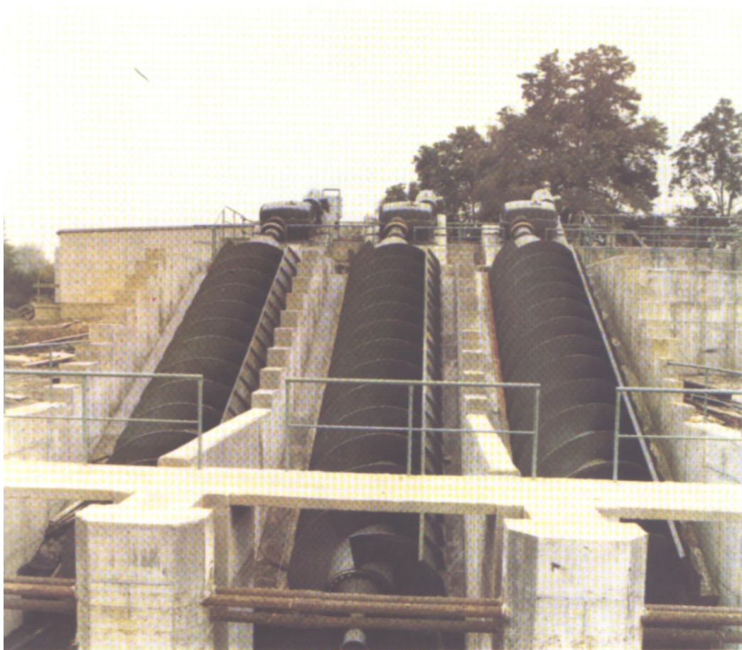
Рис. 4.36. главная насосная станция оборудованная тремя шнековыми насосами.
