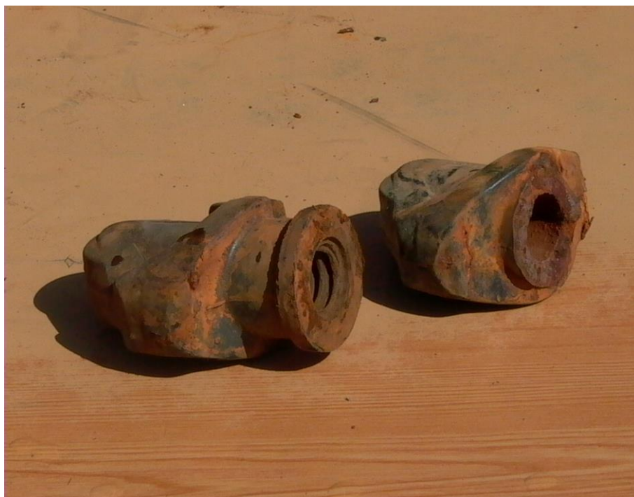
Рис. 1.2.4. Заращение внутренней полости задвижки продуктами коррозии
