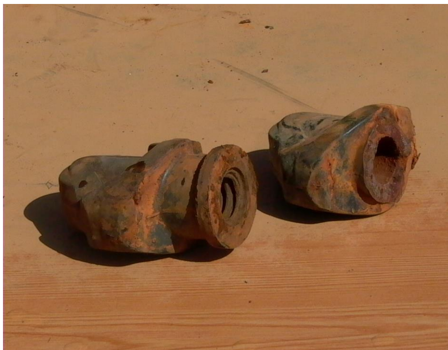
Рис. 1.2.4. Заращение внутренней полости задвижки продуктами коррозии
